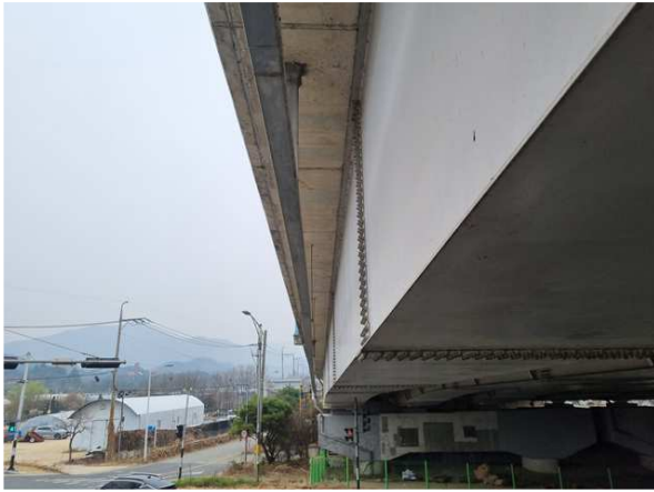
바닥관하면 S3 외측 캔틸레버 상태현황
